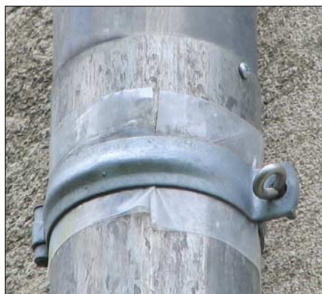
Bild 2: Isolierung des Fallrohrs vom Mauerwerk und Schraube zur Verbesserung des Kontakts zwischen den Rohrsegmenten
