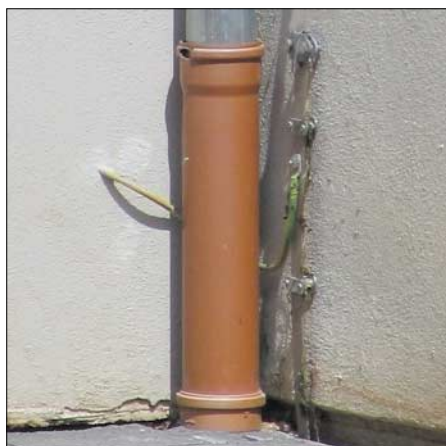
Bild 3: Hier mündet das Fallrohr in Kunststoffrohr, daher ist keine zusätzliche Isolierung notwendig. Rechts zu sehen ist der Anschluss des Fundamenteorders, links das Kabel vom Antennenkoppler zum Fallrohr, der Anschlusspunkt ist auf der Rückseite.
